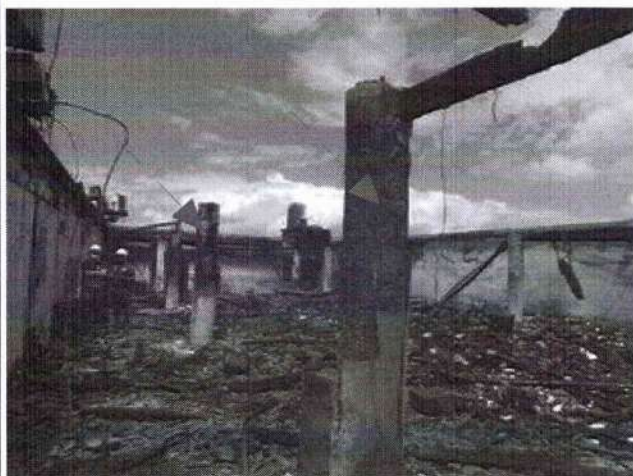
Figura 62 - Colunas com face danificada indicando o sentido de propagação do fogo.
