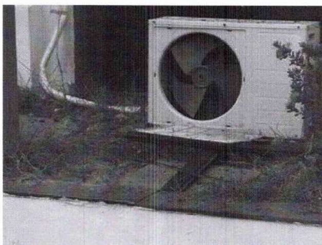
Figura 16 - Visualização dos danos na parte externa.
