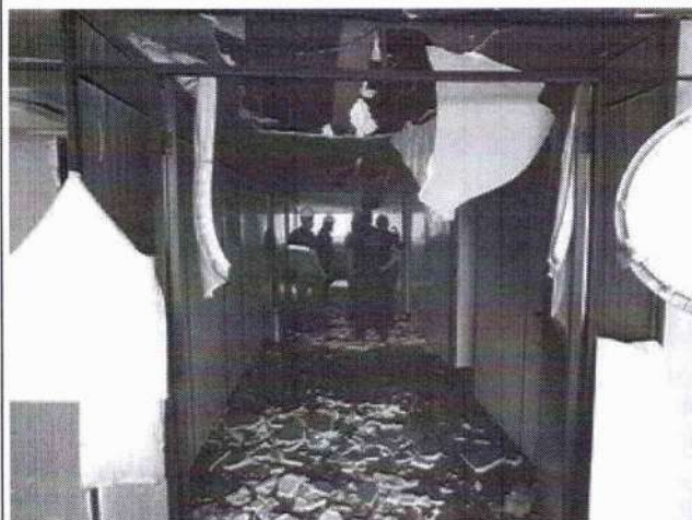
Figura 56 - Danos na cobertura e forro do corredor principal.
