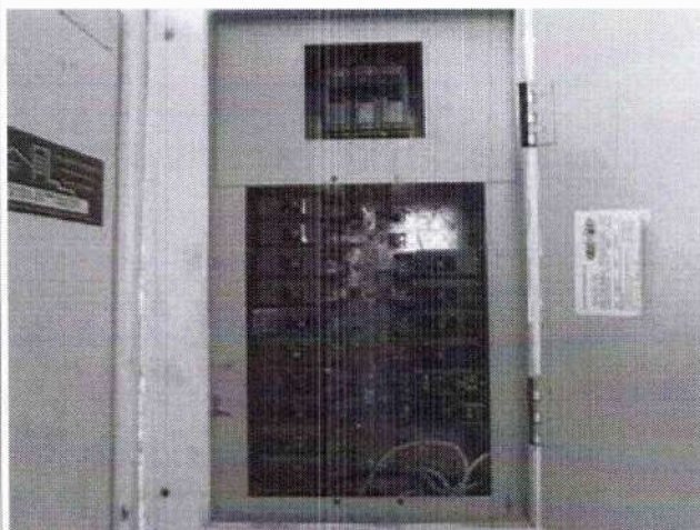
Figura 51 - Visão geral do quadro de distribuição.
