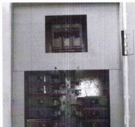
Figura 53 - Quadro de distribuição, com destaque para os disjuntores na posição ligada.
