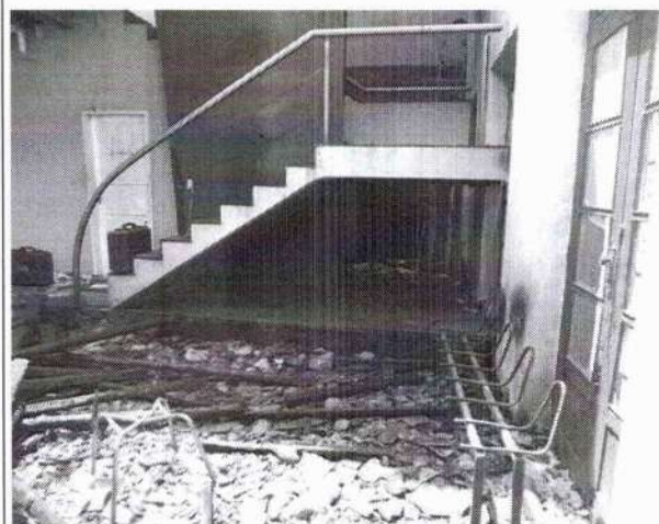
Figura 49 - Visão geral dos danos no térreo.
