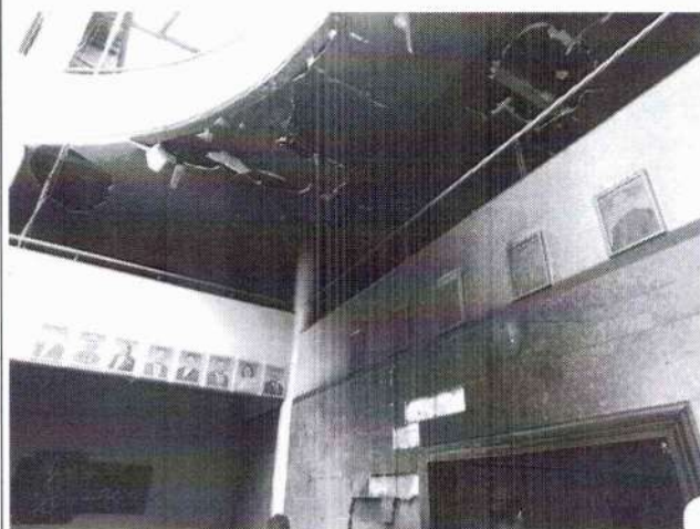
Figura 47 - Visão geral dos danos no térreo.
