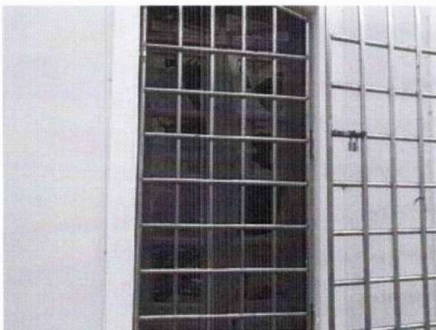
Figura 24 - Danos na porta de acesso ao imóvel, pela região posterior do imóvel.
