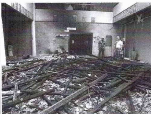
Figura 46 - Visão geral dos danos no térreo.
