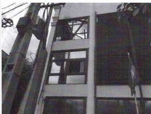
Figura 17 - Visualização dos danos na parte externa.
