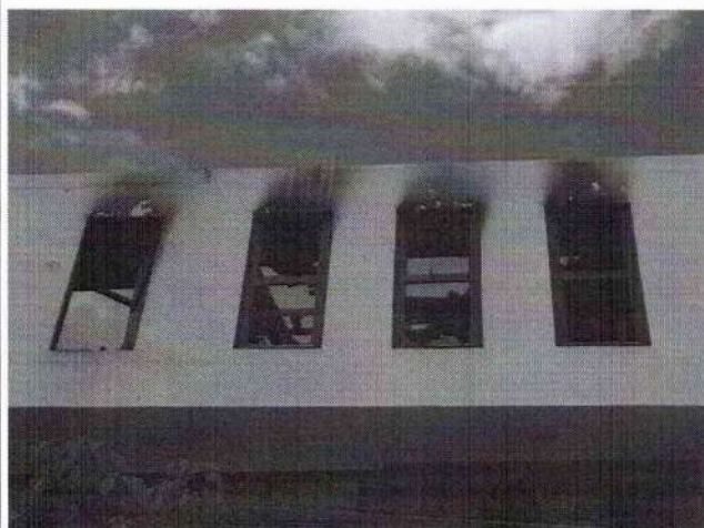
Figura 11 - Danos das janelas do pavimento superior.
