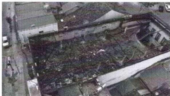
Figura 31 - Visão aérea obtida por drone, com destaque para os danos no imóvel.
