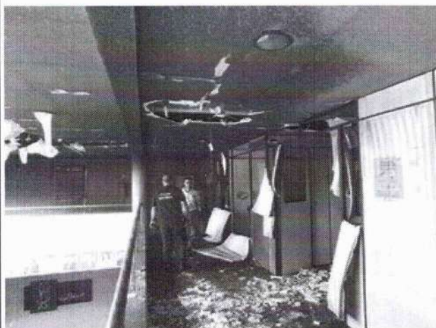
Figura 54 - Danos no teto do pavimento térreo.
