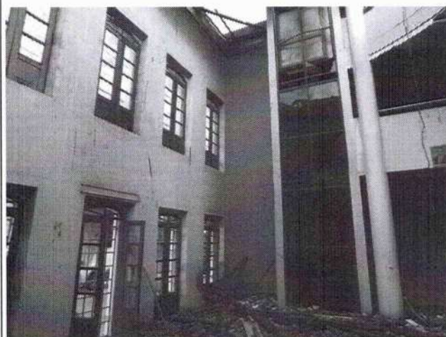
Figura 48 - Visão geral dos danos no térreo.
