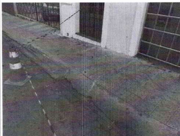
Figura 26 - Estilhaços de vidros oriundos das portas de acesso ao imóvel, pela região posterior do imóvel.
