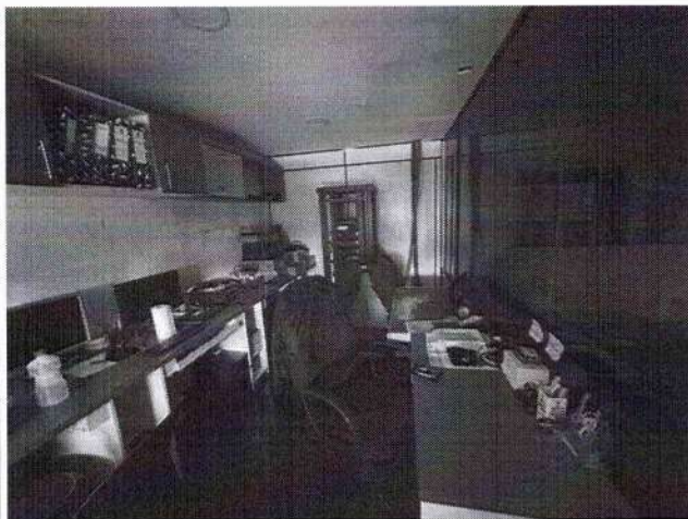
Figura 58 - Sala do sistema de monitoramento.
